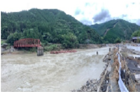
崩壊した球磨川第二橋りょう
